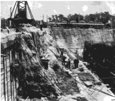
图 1 昆仑饭店北部基槽滑坡全景
