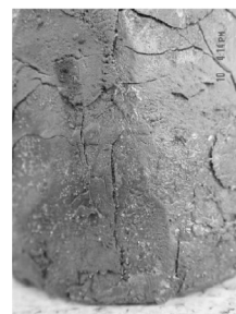
图 1 横向和竖向裂缝
