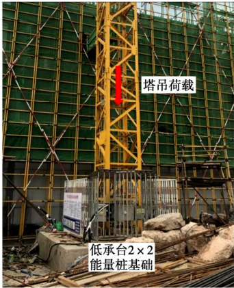
(a) 塔吊实物图
