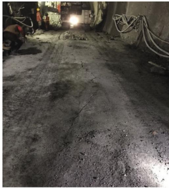
图 10 PDK50+468 断面附近仰拱开裂隆起
