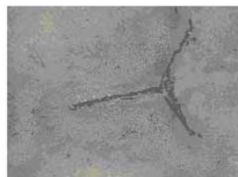
图 3 三条裂纹照片
