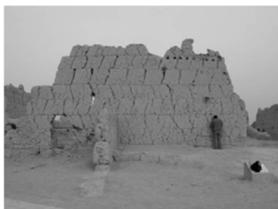
图 10 人字型裂缝 (东北佛寺南墙)
