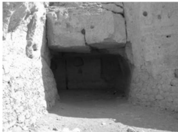
图 6 洞顶变形裂隙(东城区)
