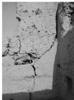
图 12 墙体接槎缝 (东城区)
