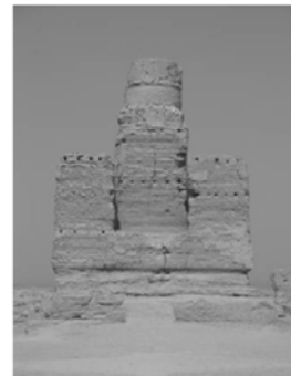
图 9 不均匀沉降引起的变形裂隙(金刚佛塔)
