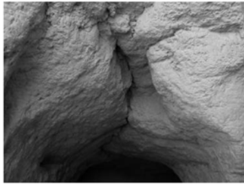
图 5 拱形窑洞洞顶裂隙(官署地道)
