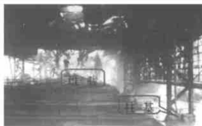
图1 某厂房屋顶的坍塌
