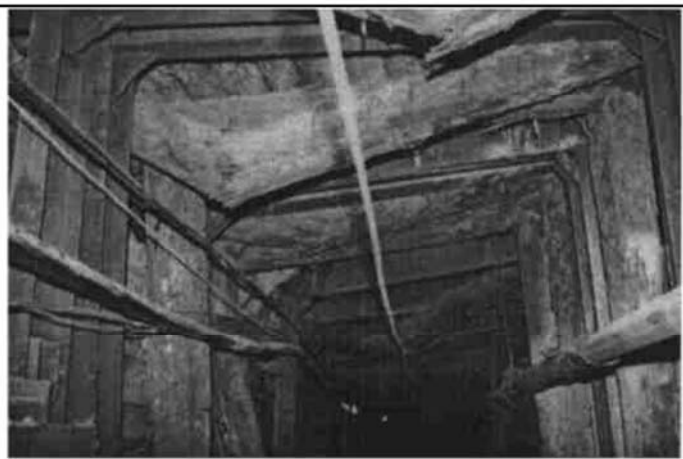
图1 主运巷塌陷破坏情况
