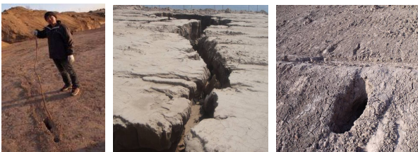
图1 某沟谷区黄土高填方地基裂缝及水毁现象
