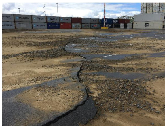
图 4 2016 年新西兰地震 Wellington 集装箱码头大量砾石喷出地表 [12]
