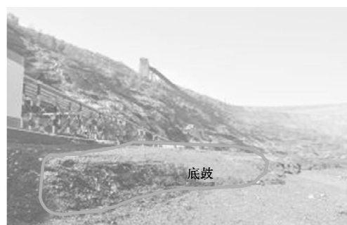
图 3 坡底-309 泵站底鼓
