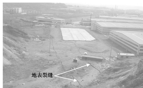
图 2 坡顶变形破坏图
